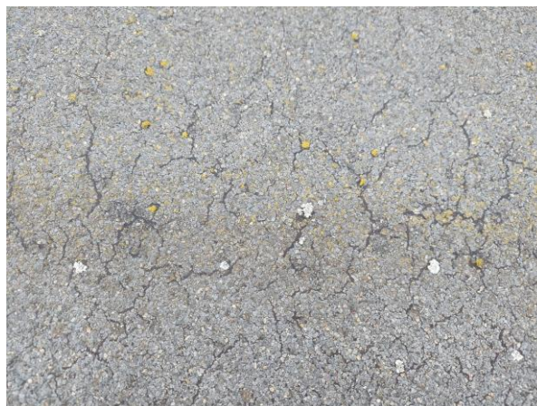
foto /8/ Detail masivních prasklin
