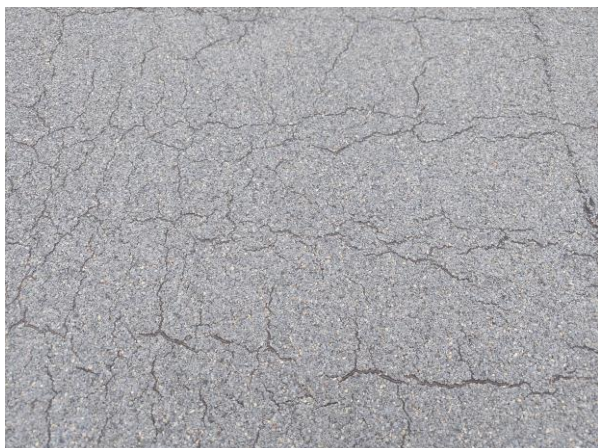
foto /7/ Detail masivních prasklin
